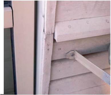
Figur 5.41 Den spikade träfasaden med skarvade trälister och sprickbildningar framstår som skamfilad i jämförelse med fönsterpartiet av aluminium intill. Foto: Förf.
