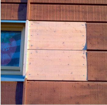
Figur 5.40 Fasad på flerbostadshus med limträpaneler. I skarven mellan det ljusmålade fasadfältet och intilliggande panel märks hur panelen kupat sig. Foto: Förf.
